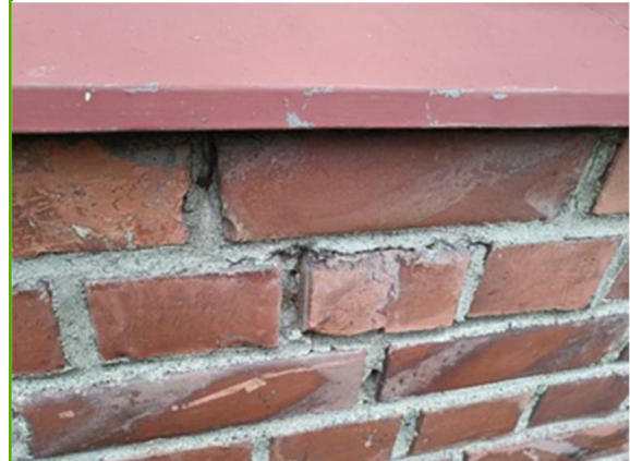
Pohjoispäädystä saumaa seuraava halkeama
