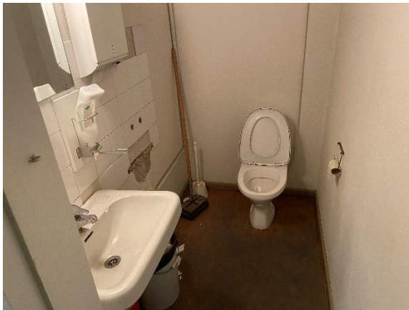
WC:n vanha muovimatto
