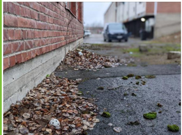
Pohjoispäädystä asfaltti kaataa rakennusta kohti, halkeama, sammalta kasvaa asfaltissa
