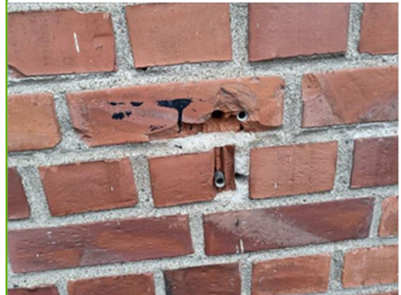
Tiiltä rikottu kiinnityksistä
