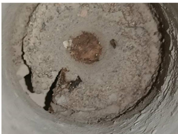
Laastia sokkelibetonin ja tiilen välissä
