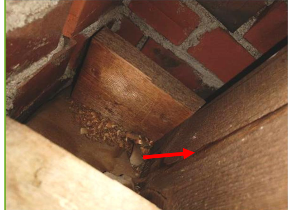
Kehäpilarin liittymässä eristettä ohuemmin, pilarissa halkeama
