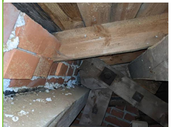
Räystäällä vesivuotojälkiä, huopa tiilen ja palkin välissä
