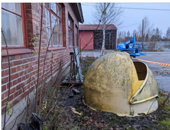
Kasvillisuus rakennuksessa kiinni länsisivulla, sammalta kasvaa asfaltissa
