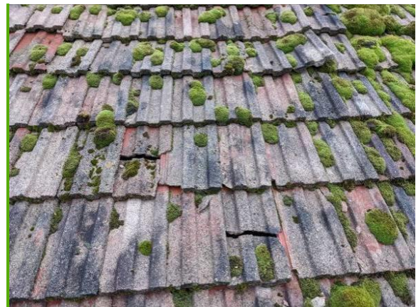
Haljenneita tiiliä, tiili rapautunut
