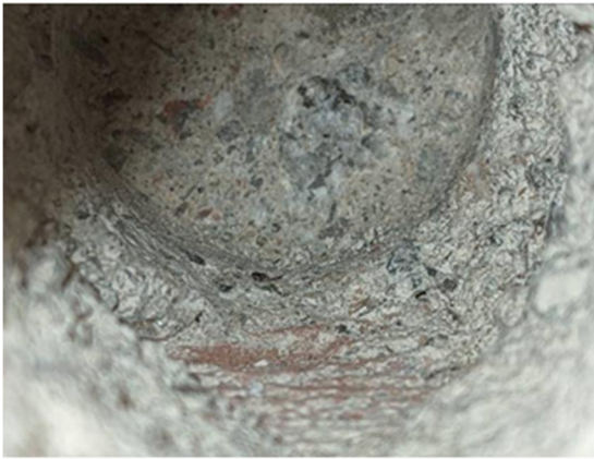
Julkisivumuurauksen ja aukkopalkin välissä ei eristettä
