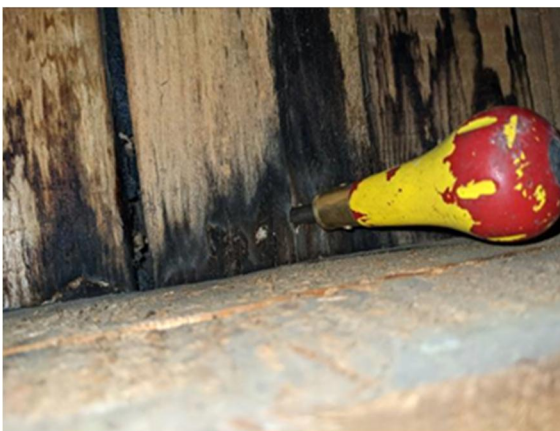
Alusruoteet lahonneet läpiviennin ympäriltä
