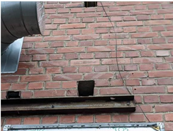
Pohjoispäädystä vanhoja aukkoja ja reikiä
