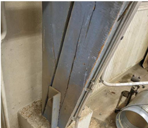
Kehässä halkeamia liitoksessa
