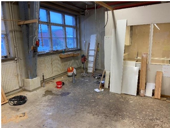
Värjäytymää lattiassa, mahdollisesti maalia tai lakkaa
