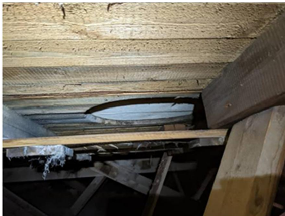
Vanha läpivienti laitettu umpeen, vuotoja tapahtunut läpiviennistä
