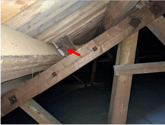
Orret vääntyneet, halkeamat syvällä
