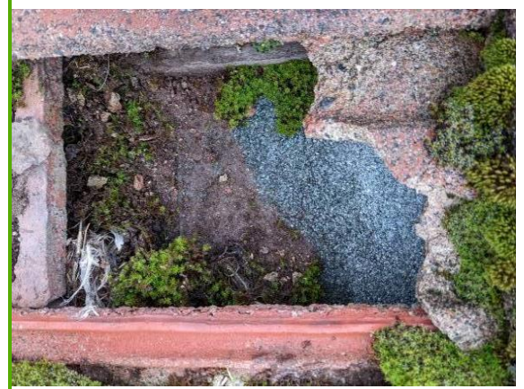
Länsilappeella uusittu aluskatetta vanhan läpiviennin kohdalta, aluskatteen yläpinta sammutettu, ei ruoteita
