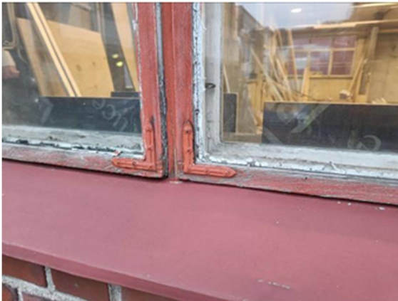
Lasituskittaukset kuluneet, puuosat halkeilleet
