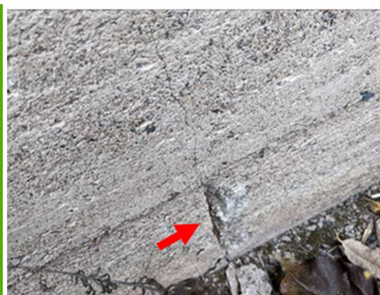
Sokkelissa havaittiin useita pystysuuntaisia halkeamia, ruostunut teräs pinnassa halkeaman kohdalla
