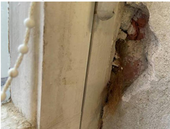
Ikkunakarmi rapattu hieman yli sisäpuolelta
