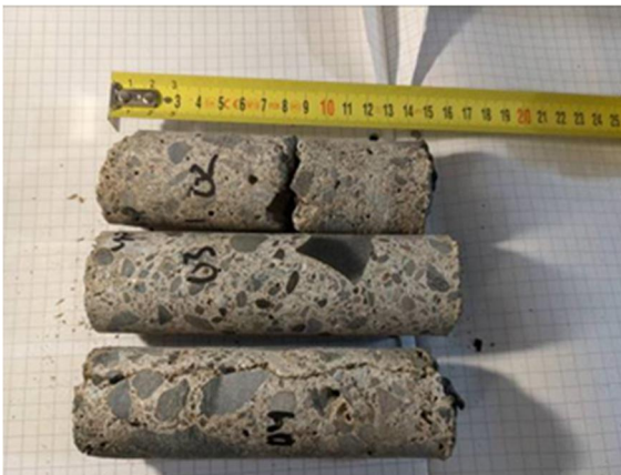
Yleiskuva sokkelibetonista, näytteet 02-04, näytteessä 04 halkeama läpi betonin
