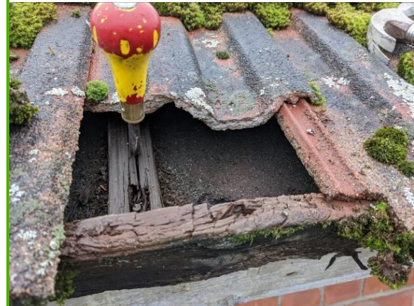
Umpinainen räystääs alkanut lahoamaan
