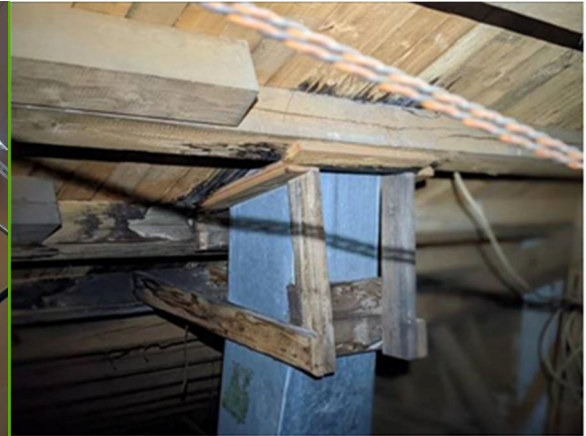
Vesivuotojälkiä läpiviennin ympärillä
