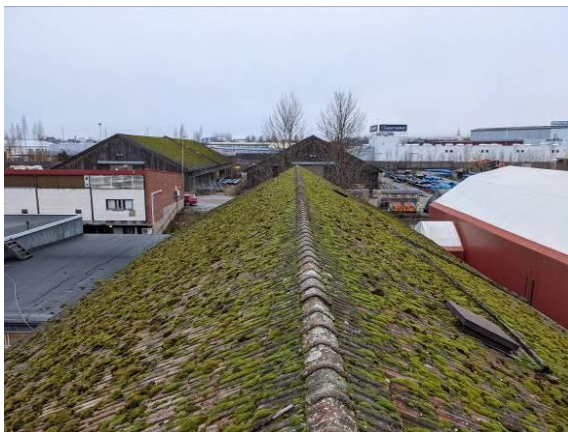
Yleiskuva vesikatosta, vesikate sammaloitunut
