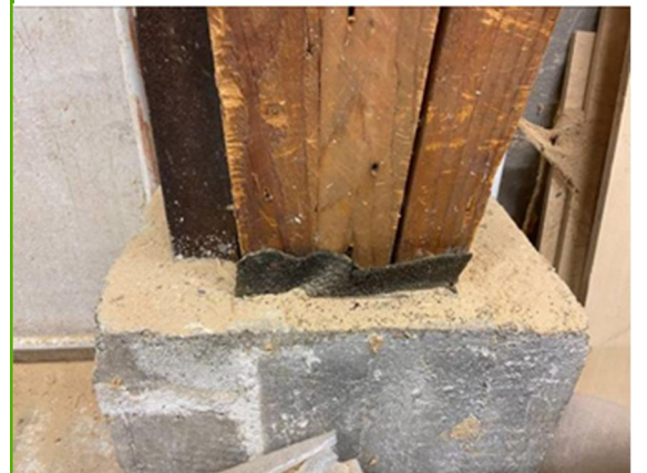
Kehä erotettu betonista kermillä
