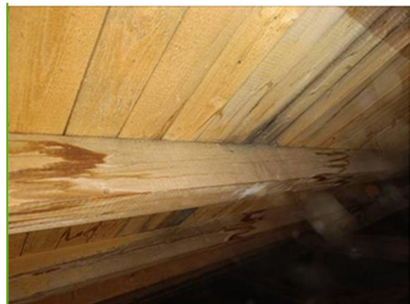
Vesivuotojälkiä ja tummentumia puuosissa
